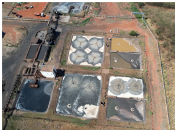
Estação de tratamento de esgoto (ETE).
